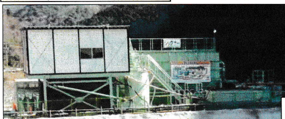
トンネル排水の処理設備
